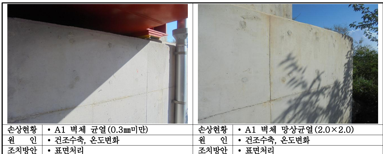
【사진 29.3.9】 교대 손상현황
